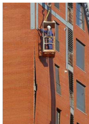
Fotografía 14: Deshojamiento de fachada
