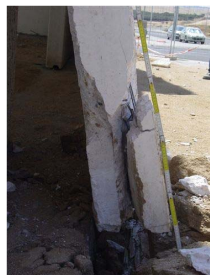
Fotografía 12: Detalle de la rotura
