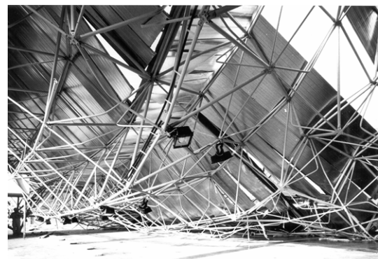
Fotografía 6: Colapso de la cubierta de un pabellón polideportivo
