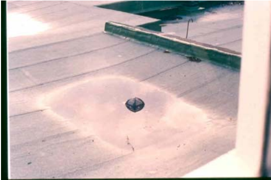
Fotografía 7: Acumulación de agua por falta de mantenimiento de los desagües
