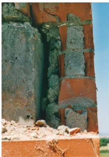
Fotografía 13: Falta de apoyo de la fábrica
